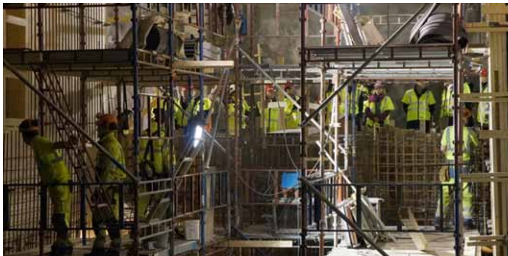
Tunnelirakentamisen työmaajärjestelyjen sekä henkilö- ja materiaalilogistiikan haastavuus kävivät havainnollisesti ilmi kun laivaseminaarin osanottajat tutustuivat Tukholman Citybananin City-aseman työmaahan.
